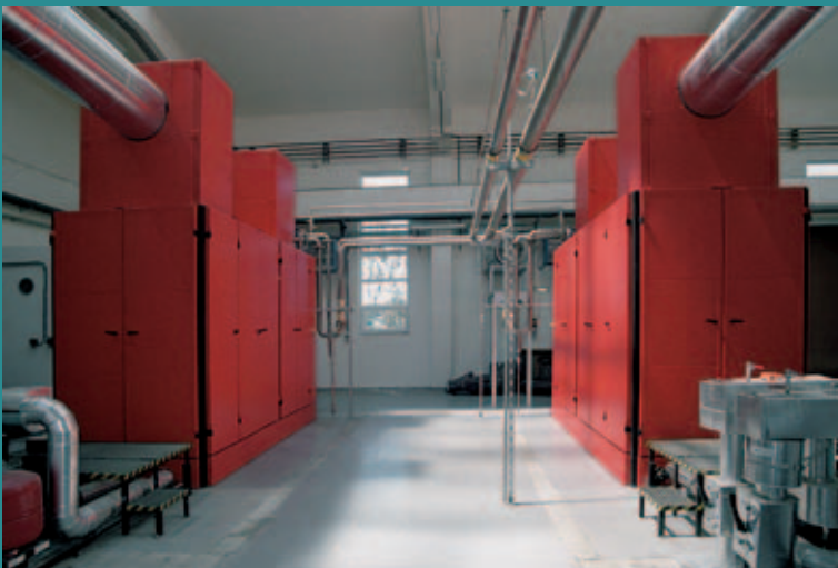
станция водоочистки г. Брно – мощность 2 x 520 кВтэ
