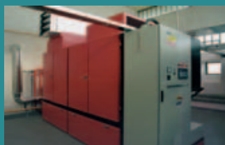
Водоочистная станция г. Чешка Липа
